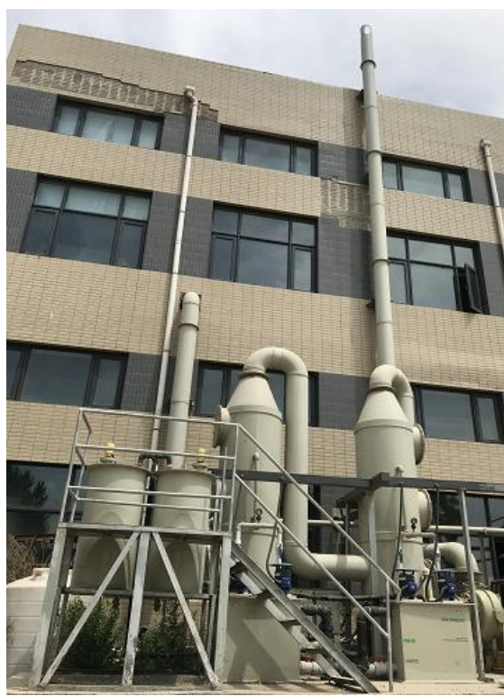
尾气处理设施及排气筒
